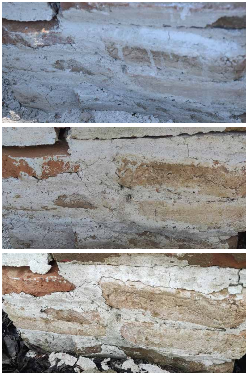
Slika 117b. Monitoring primenjenih mešavina maltera na zidanim strukturama u Viminacijumu: Struktura 4 – nakon 35 dana, jul (gore); nakon 128 dana, oktobar (sredina); nakon 255 dana, februar (dole)
