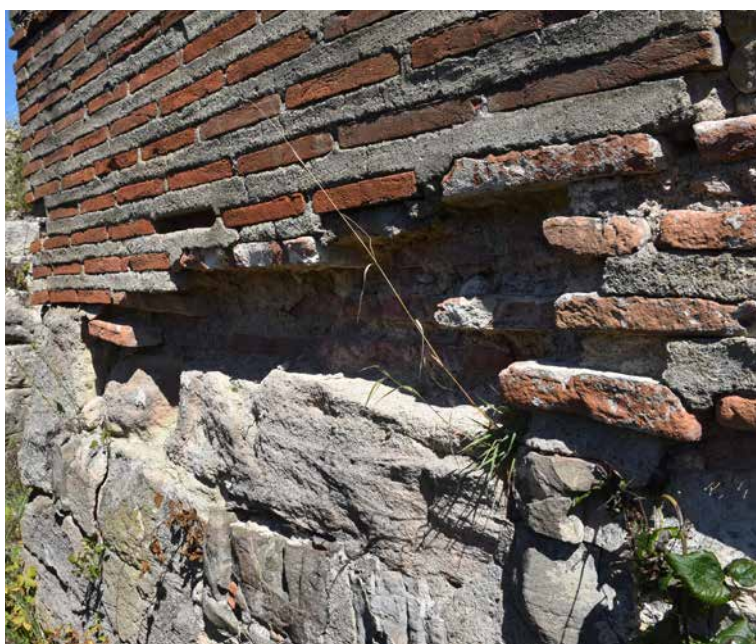
Slika 127. Restauriran zid i spojnice u istorijskom tkivu izvedeni nekompatibilnim cementnim malterom pre više decenija
