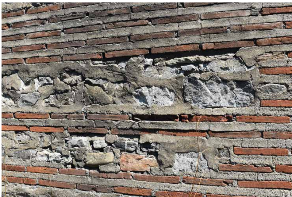
Slika 82. Nekompatibilnost cementnog maltera sa elementima za zidanje, konzervacija izvedena pre više decenija
