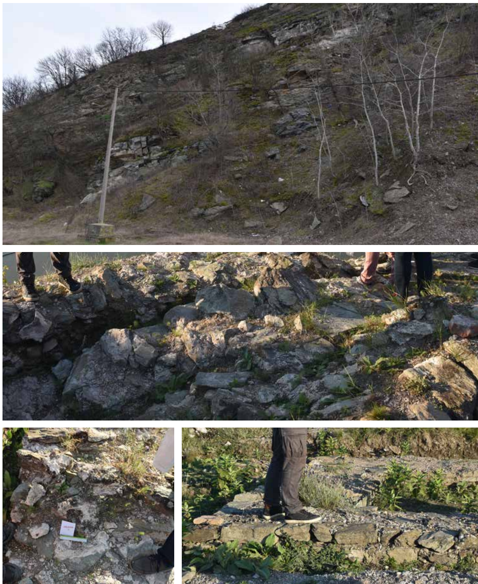
Slika 122. Lederata: stena na kojoj je fundirano utvrđenje (gore) i zidovi utvrđenja od škriljca (sredina i dole)
