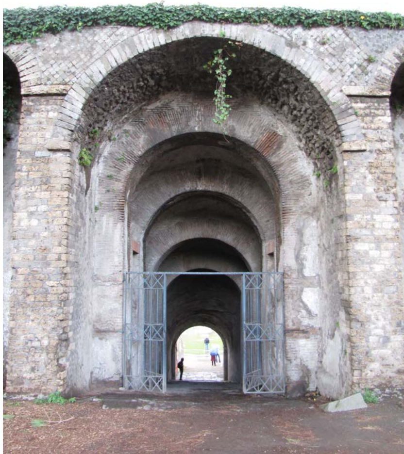
Sl. 233. Pilasteri unutar Severozapadnog ulaza u amfiteatar u Pompeji (foto: I. Bogdanović)
