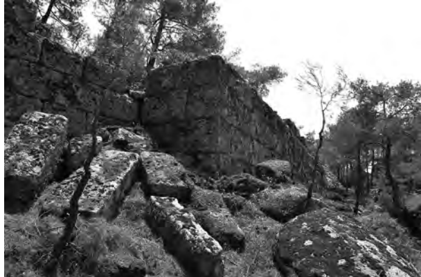
Fig. 2.4.48 : Vue du décrochement du mur de fortification de Asarlık Tepe (depuis le Nord) (O. Henry).
